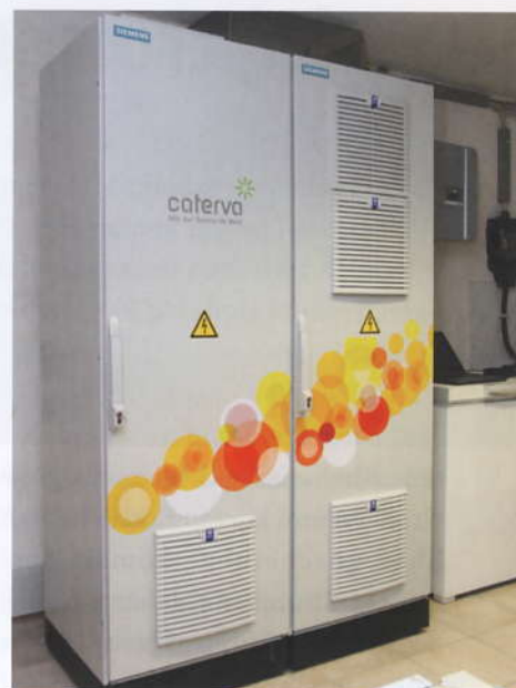
Im Rahmen des Pilotprojekts SWARM wurden über 65 Energie-Speicher-Systeme installiert.
